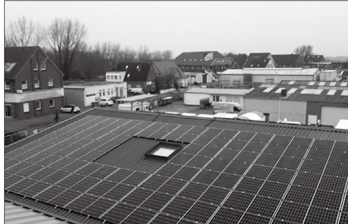
Die Photovoltaikanlage auf dem Dach des Getränkemarktes im Gewerbegebiet ist eines von mehreren Photovoltaikprojekten der Reederei. Foto: Reederei Norden-Frisia
