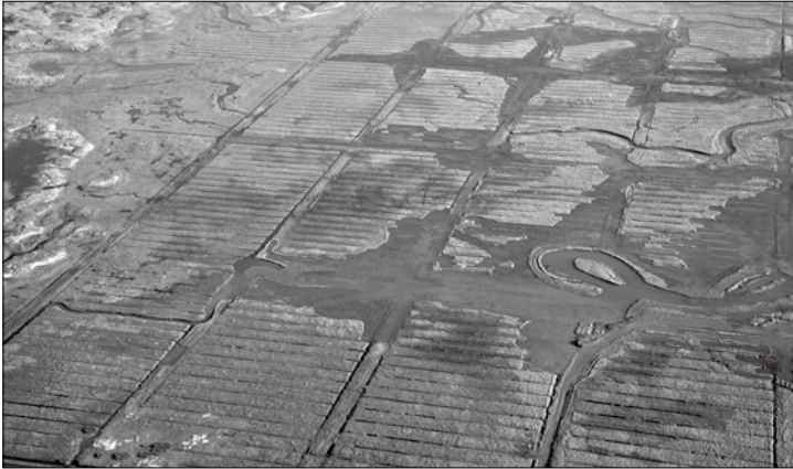
Luftaufnahme vom Ostheller. Im Hintergrund ist die Fläche zu sehen, die bereits 2008 renaturiert wurde, im Vordergrund die Fläche, auf der die Arbeiten nun abgeschlossen wurden. Foto: Tennet
